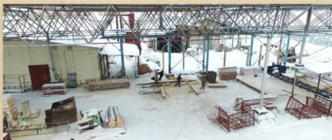
Участок распиловки, вид сверху
